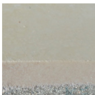
Verfärbung ohne Bitumen Primer
