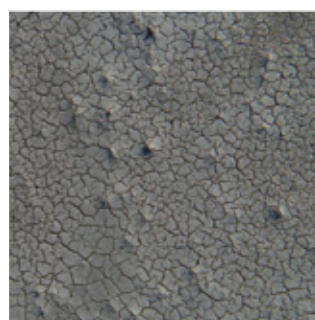
Krakelierung / Rissbildung ohne Bitumen Primer
