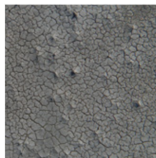
Krakelierung / Rissbildung ohne Bitumen Primer
